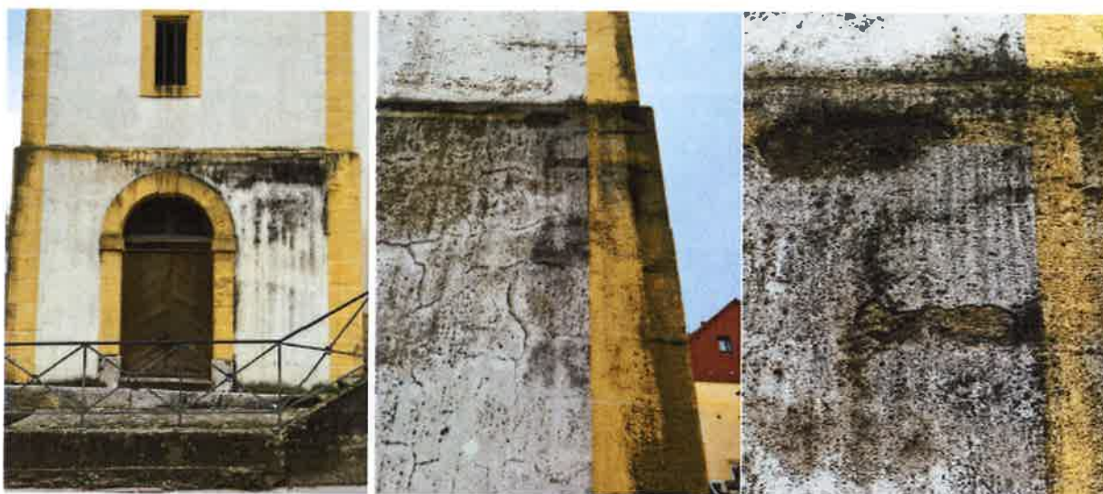
Exemples de détérioration sur les façades.
